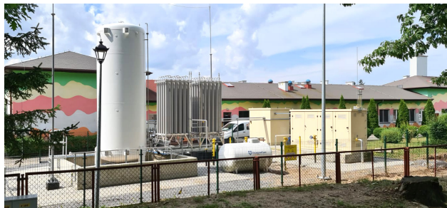
Kamieniec Ząbk. - nowa stacja regazyfikacyjna, inwestycja PSG.
